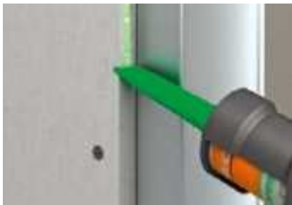
Führen der 310-ml-Kartusche an der Plattenkante. Die spezielle Kleberspitze sorgt für die exakte Klebermenge bei 10- und 12,5-mm-Platten. Bei 15- und 18-mm-Platten muss die Spitze angeschnitten werden
