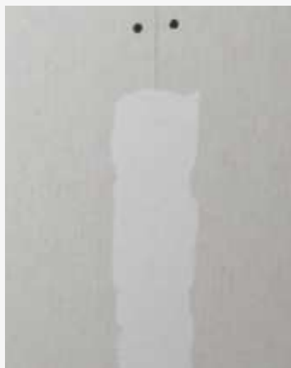
Teilweise vorgenommene Fugenspachtelung
